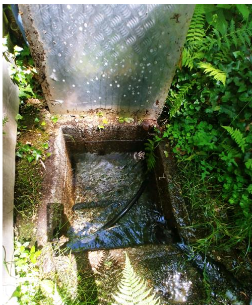
Captage d'eau en parcelle D49. Source : Photo prise lors de la visite du 5 Juin 2024
