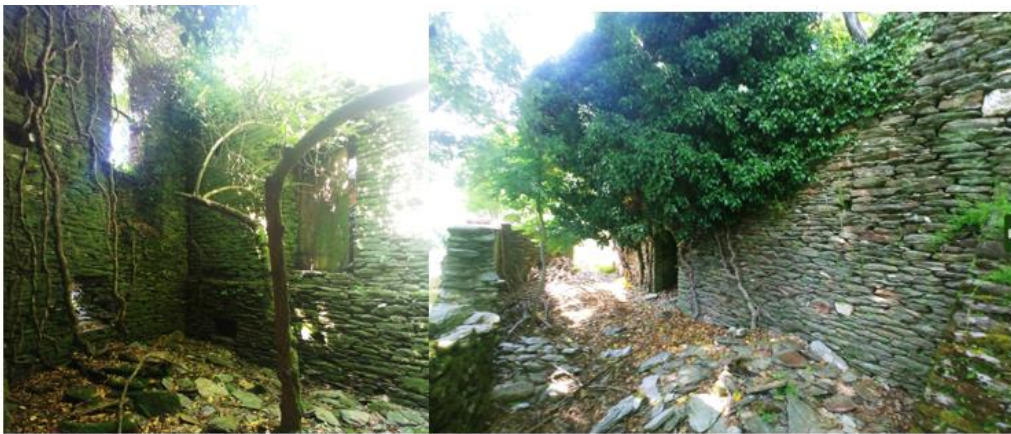
Ruine en parcelle C314. Source : Photos prises lors de la visite du 05/06/2024
